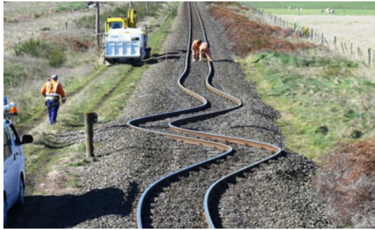
Figura 3.5: Dilatação térmica em trilhos de uma linha férrea após acontecer um incêndio florestal. Fonte: [81]
